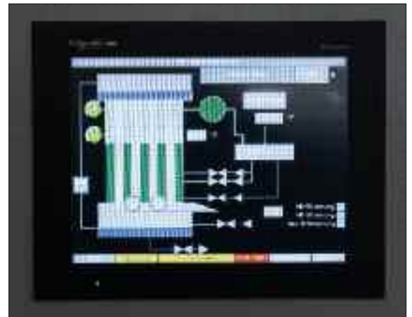
Zentrale Anlagensteuerung mit digitalem Touch-Screen-Panel
